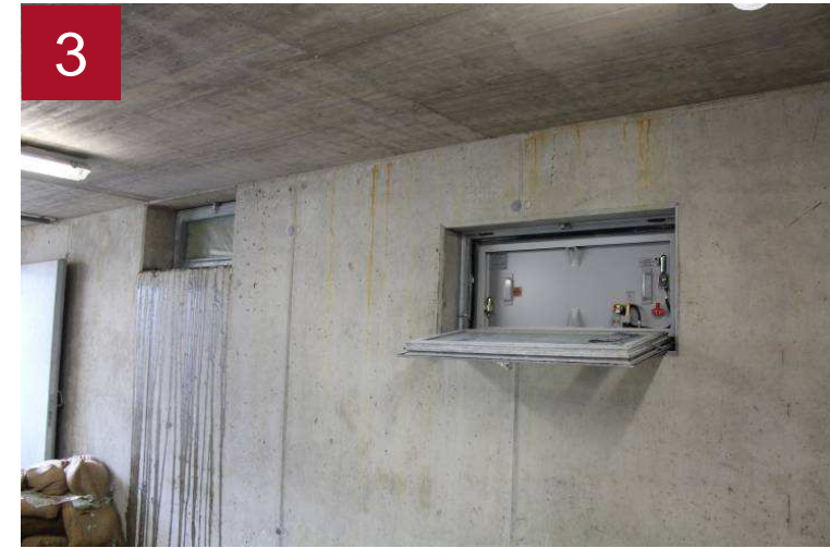
3 Links Wassereintritt, rechts dicht mit PrevFix
