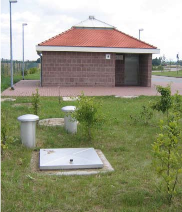
System GULLIVER® an einer Autobahnraststätte
