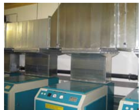
Kompressor mit Abluftsystem
