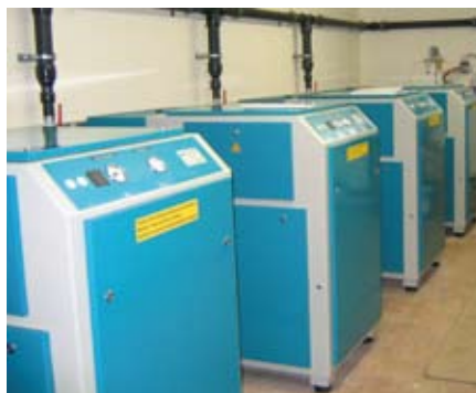
Kompressoren im Betriebsraum
