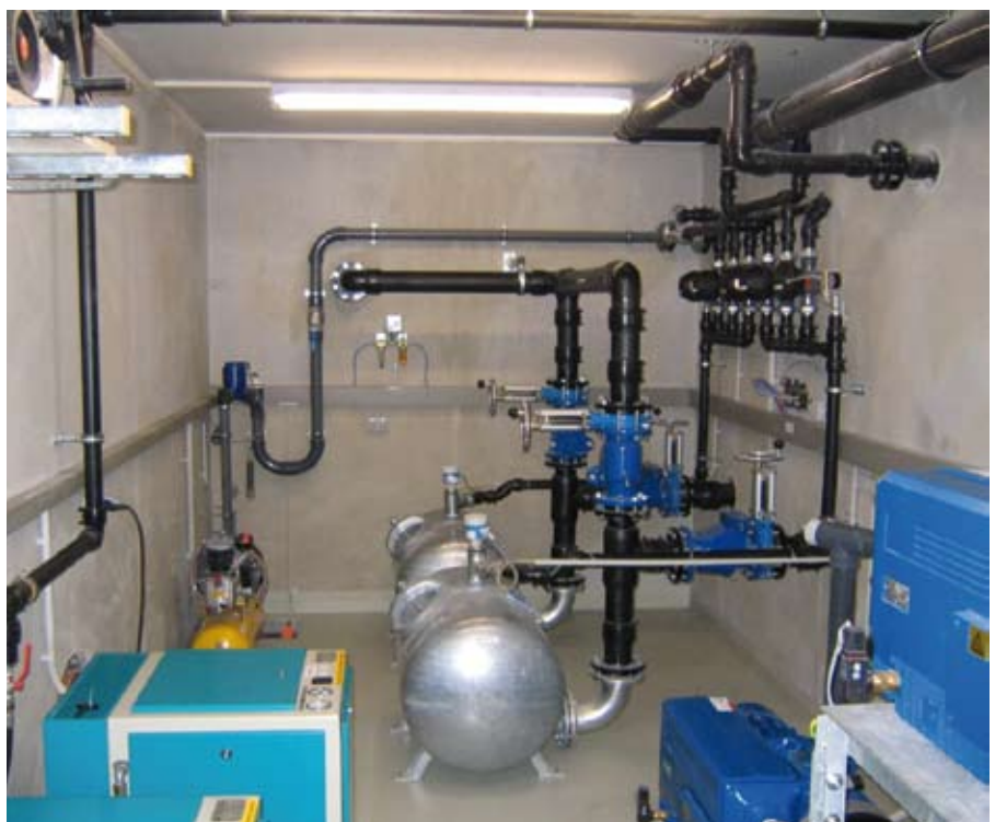
Anlagenraum eines Pumpwerks GULLIVAC®
